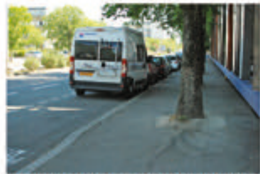
2 : Bande le long de l'Avenue, sol des trottoirs dégradé
