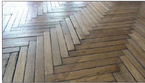
Soulèvement ponctuels du sol
