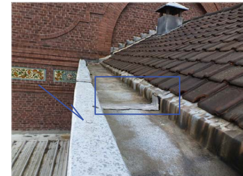
Chéneaux zinc avec clous cabotins. Corrosion importante du zinc et présence de pax alu. <Réfection à neuf des chéneaux et solins en zinc prépatiné.
