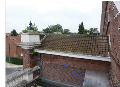
Couvertures tuiles et bac acier de la Façade principale: <Réfection complète compris chéneaux et terrasson zinc de l'escalier menant au R+1.
