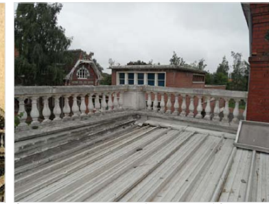
Couvertures bac acier et chéneau encaissé fortement dégradées: <Réfection selon couverture d'origine: terrasson zinc à tasseau.
