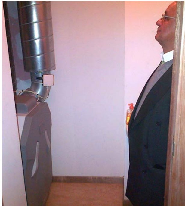
Figure 96 : Monsieur Fadel, occupant de la « rue Fin » face à sa VMC double flux, crédit photo Eric Ruiz.
