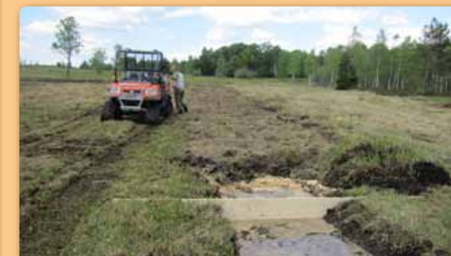
Photo 27 - En fonction de la topographie, deux techniques différentes ont été utilisées (bouchage à la sciure et palissades) pour restaurer le fonctionnement hydrologique de la tourbière. (© Communauté de communes Frasne-Drugeon)
