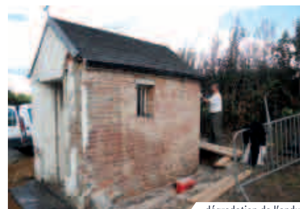
dégradation de l'enduit
