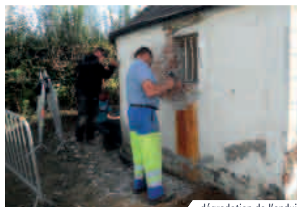
dégradation de l'enduit
