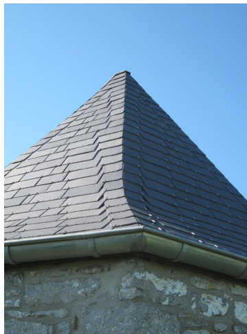
© GAL BH/MUAP : restauration de la toiture de la chapelle Bon Secours de Grandrieu (SIVRY-RANCE) suite au subside du PPPW
