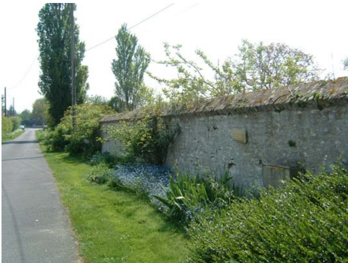
Crochte : un mur de ferme en brique chaulée, son couronnement est fait de brique formant V. Krochte : gemetste en bekalkte muur rond een boerderij, afwerking met baksteen in V-vorm.
