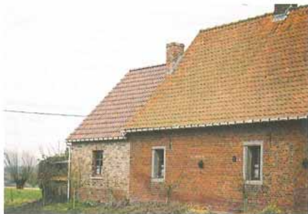
un volume secondaire à deux versants correctement réalisé, malgré une teinte de matériaux inadaptée
