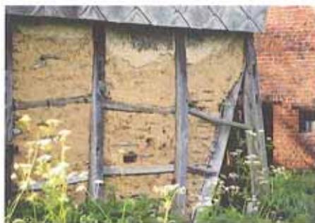
un détail de paroi en torchis composée de l'ossature en bois, du clayonnage et du remplissage à base de terre
