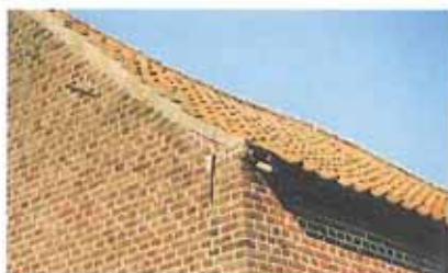
un débordement du toit sur le mur gouttereau traditionnel et lié à l'absence de gouttière
