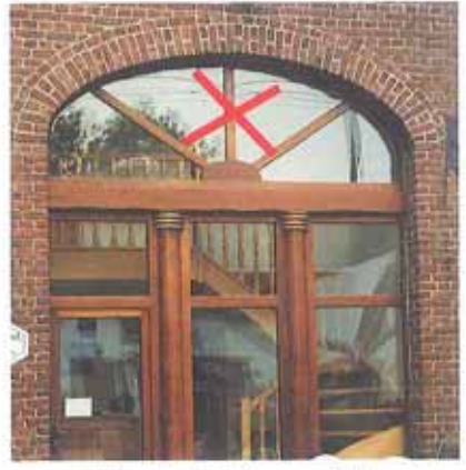
... ni utiliser de châssis aux divisions trop marquées ou inadaptées à la géométrie de la baie (voir détail ci-dessous)
