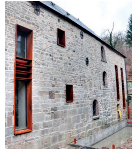
Rénovation avec percement de nouvelles baies pour amener plus de lumière au sein du bâtiment. Les nouvelles baies sont habillées d'acier Corten. L'intervention contemporaine est ainsi bien démarquée de l'existant tout en s'y intégrant. © Bureau Coupez & Associés Architectes sprl.
