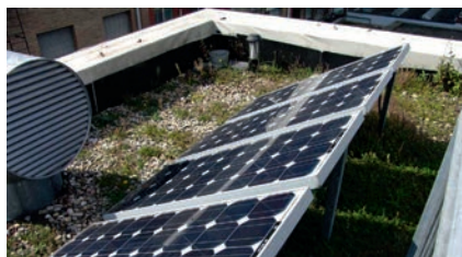
Toiture verte combinée avec l'installation de panneaux photovoltaïques.
