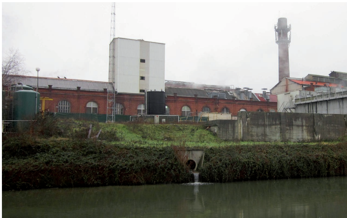
Rejet des eaux usées dans le Bras de Bousbecque
