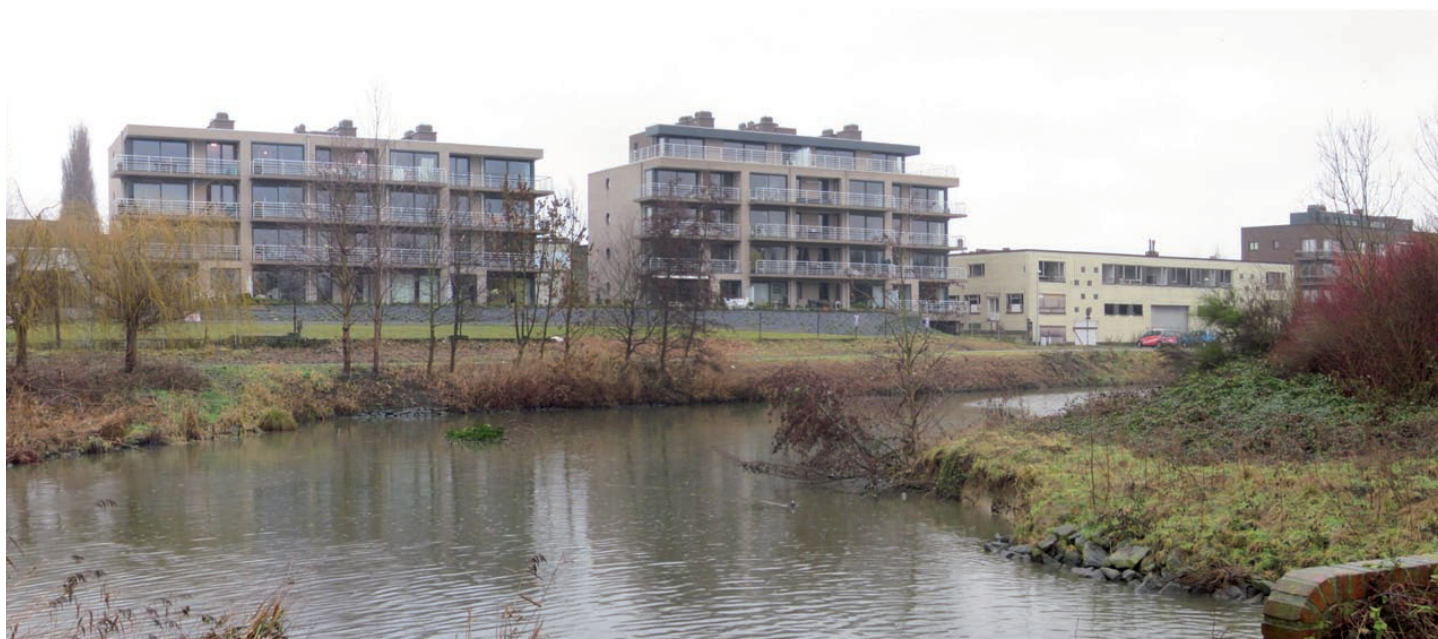
Résidences «Bellevue» en construction le long du bras d'eau à Wervik (Belgique)
