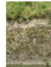
Végétation sur les Mur de fortifications surplombant l'étang Monnier
