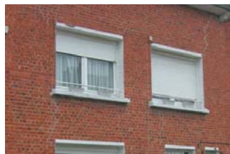
Maçonnerie de briques avec linteau et appui de fenêtre en béton fin
