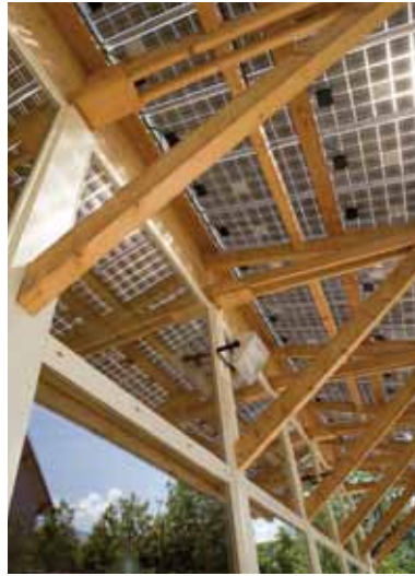
J.P. Fauré - Toiture solaire photovoltaïque
