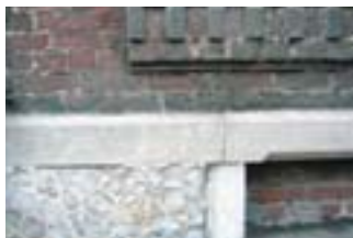
Alternance de briques et pierre bleue avec variante de mise en oeuvre
