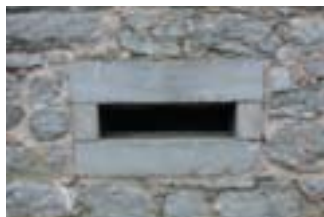
Ventilation de cave dans un mur de pierre bleue
