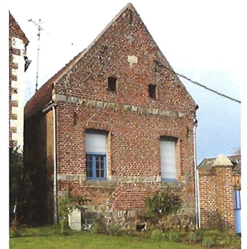
Trace de blocure sur le pignon à Sepmeries.
