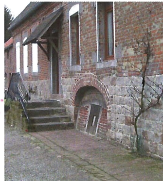
Blocure sur la façade sur cour à Salesches.
