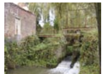
Vannerie et logement en ruine.
