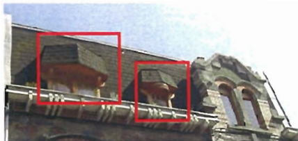
Maison dont la forme des toitures des deux lucarnes a été modifiée. Conséquence : perte de la qualité esthétique du bâti.
