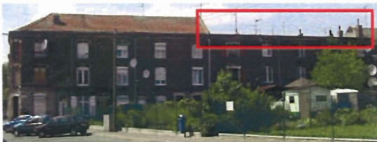
Rang de maisons dont la toiture deux pans a été remplacée pour partie par une toiture-terrasse. Conséquences : mise en place d'une rupture dans le rang et perte d'espace à l'intérieur du bâti (suppression des combles).
