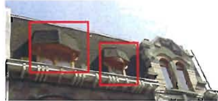
Maison dont la forme des toitures des deux lucarnes a été modifiée. Conséquence : perte de la qualité esthétique du bâti.
