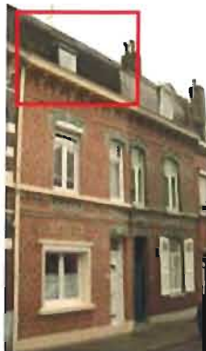
32-34 rue du Colonel Fabien : Ensemble de deux maisons dont le brisis de la toiture est à l'origine couvert en ardoises. La maison de gauche les a remplacés par un matériau de substitution (bardeaux d'asphalte, "shingles"). Conséquences : perte d'un élément d'unité des deux maisons et perte de la qualité de la couverture.
