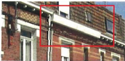
15-19 avenue Salengro : Maisons en rang dont les parties menuisées du chéneau ont été recouvertes d'une protection PVC. Conséquences : rupture dans le rang bâti et perte de la qualité esthétique du bâti.
