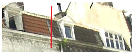
22-26 rue de la Motte : Maisons en rang dont certaines ont refait leur toiture avec le même matériau (la tuile) mais de couleur plus sombre.
