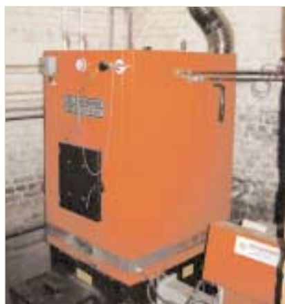
La chaudière à bois automatique
