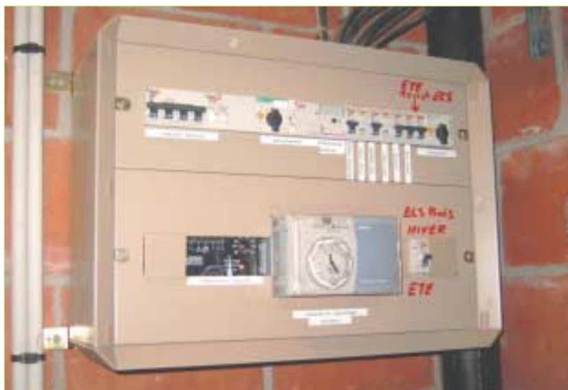
Le système de gestion automatique "bois-solaire"
