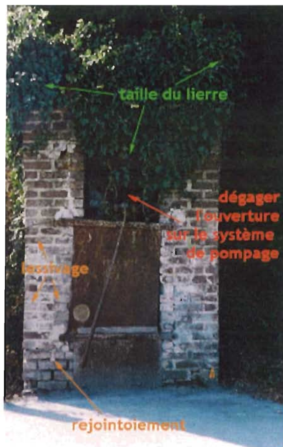
La pompe vue de face
