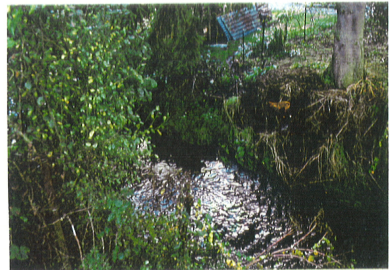
Etat de dégradation des berges du Stordoir
