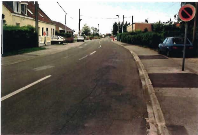
Chaussée et trottoir en mauvais état. Pas de gestion du stationnement
