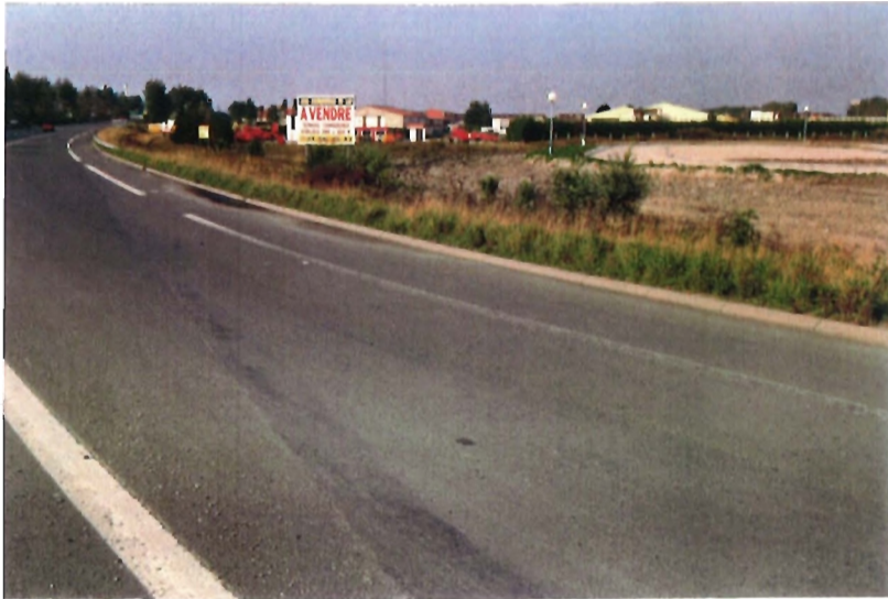
Les arrières de la zone d'activité en limite avec la N 225 sont à requalifier en cohérence avec les emprises routières restantes
