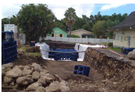
Infiltration sous parking
